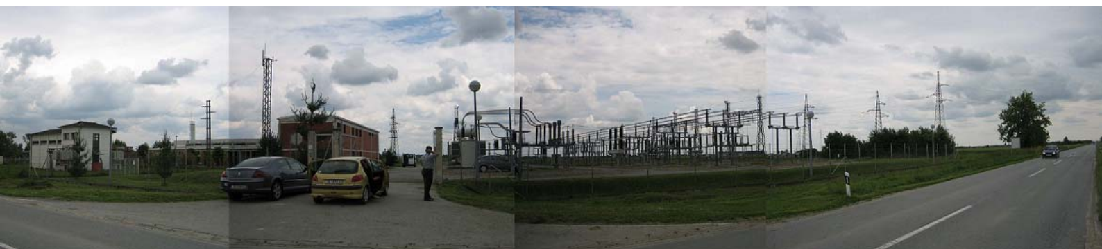
POSTOJEĆA TRAFOSTANICA TS 110/35 kV DONJI MIHOLJAC
