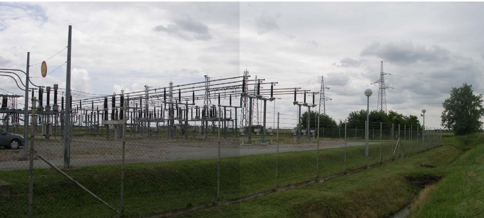
TS 110/35 kV DONJI MIHOLJAC - POSTOJEĆA TRAFOSTANICA U SKLOPU INDUSTRIJSKE ZONE
